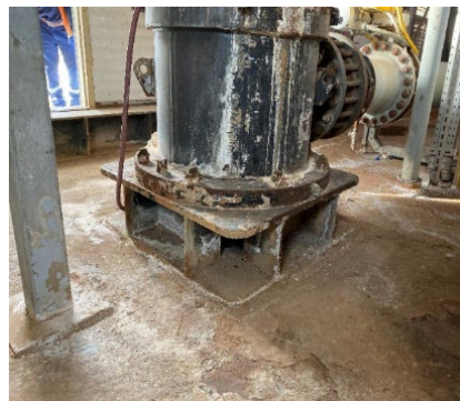
Зураг-2. Хөвдөг байшин доторх насосны суурийн 4 буланд байдаг нүх
